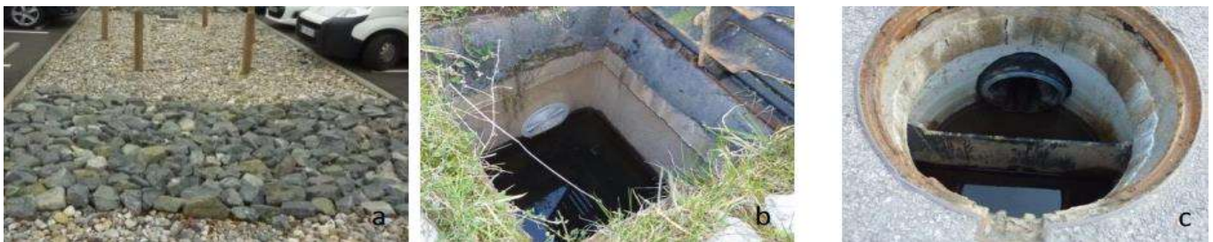
Figure 41 : a) Tranchée drainante – b) Grille de collecte avec filtre – c) regard sur tranchée avec drain
