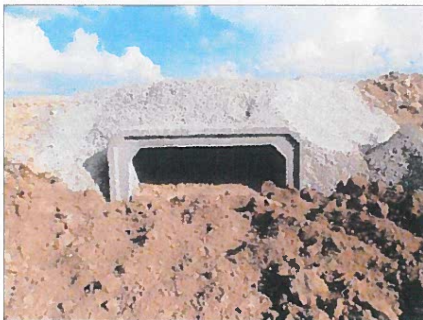
Dalot mis en place pour la petite faune sur un chantier en Alsace (photo Thauront/Ecosphère)
