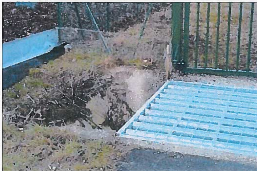
Exemple de bassin de décantation bien protégé au niveau de l'entrée (Déviation de Molsheim, photo Thauront/Ecosphère)
